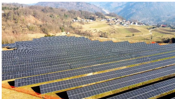
Slika 23: Sončna elektrarna Prapretno.
